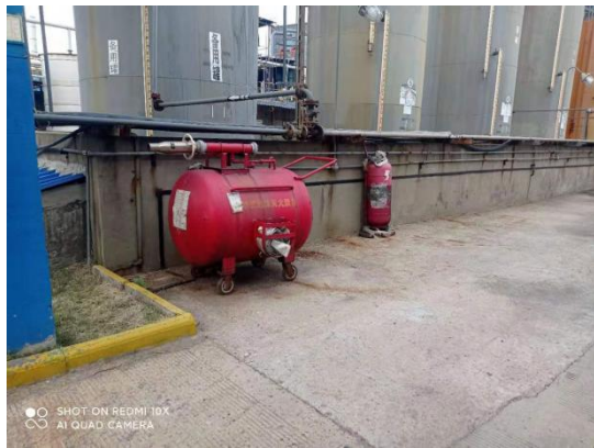
罐区消防设施
