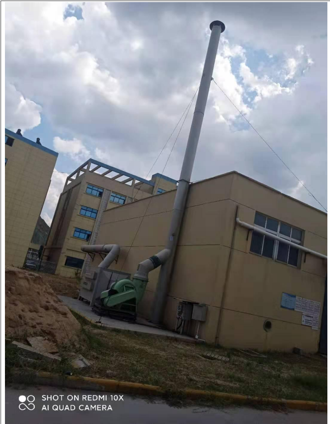
原料仓库废气应急设施
